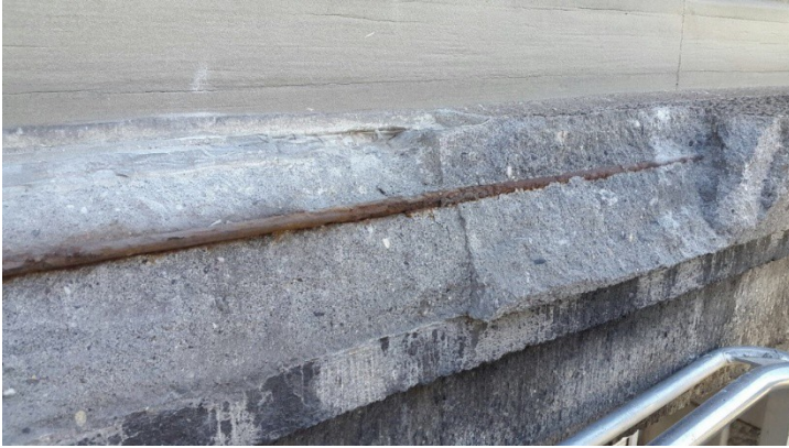
0524 Schaden durch rostende Armierungseisen im Kunststein.
