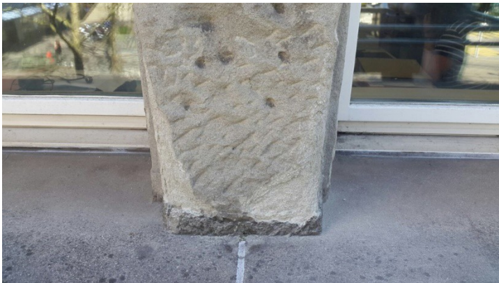
0576 Schaden an Mittelgewände, durch zu harte Fuge.
